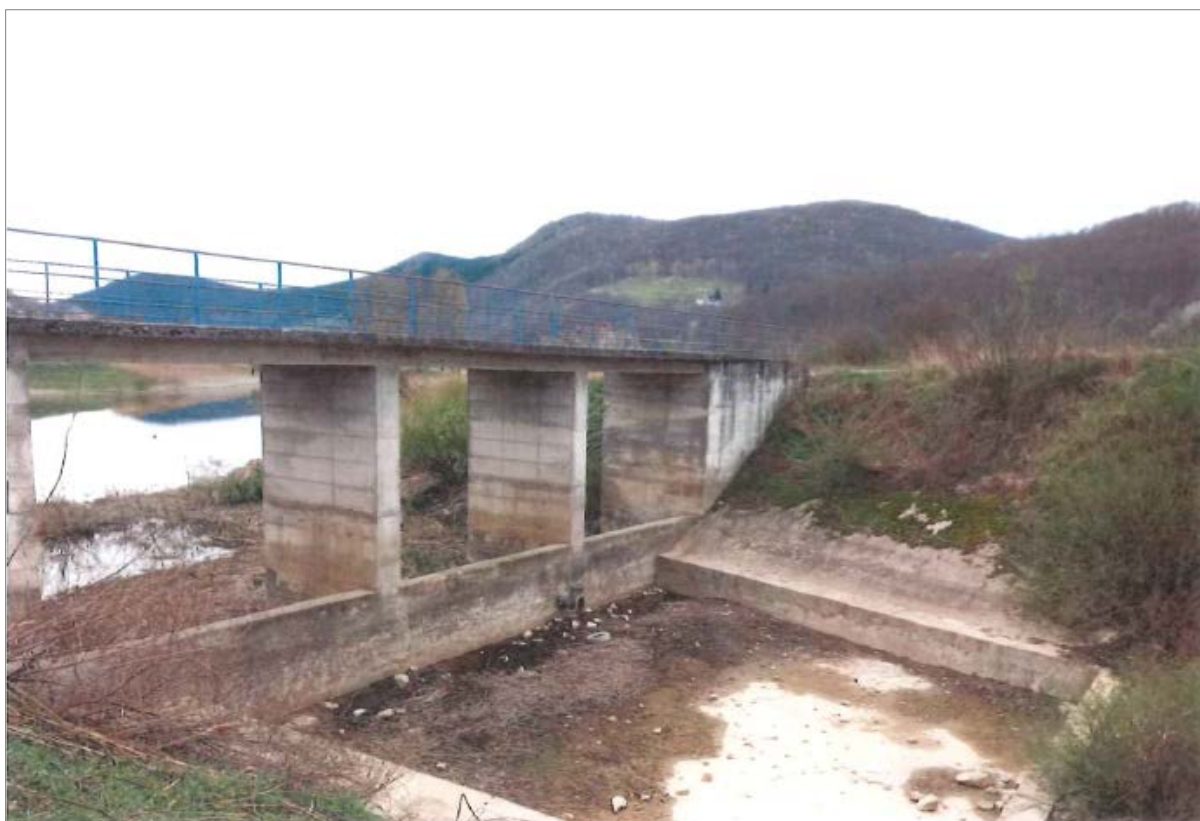
Slika 7. Pogled na pregradni prag s bučnicom i kolnim prijelazom s nizvodne strane
